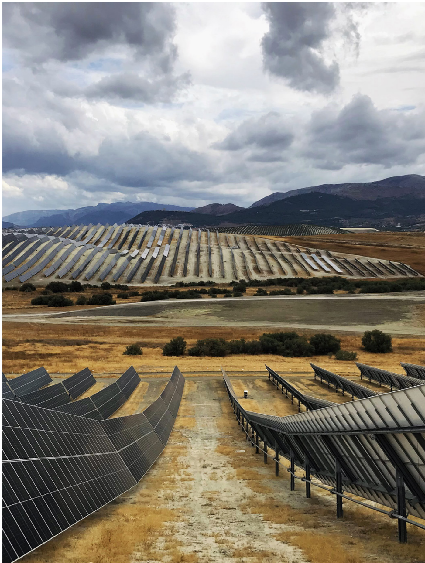
Los Olivares Solar Park. Spain.
