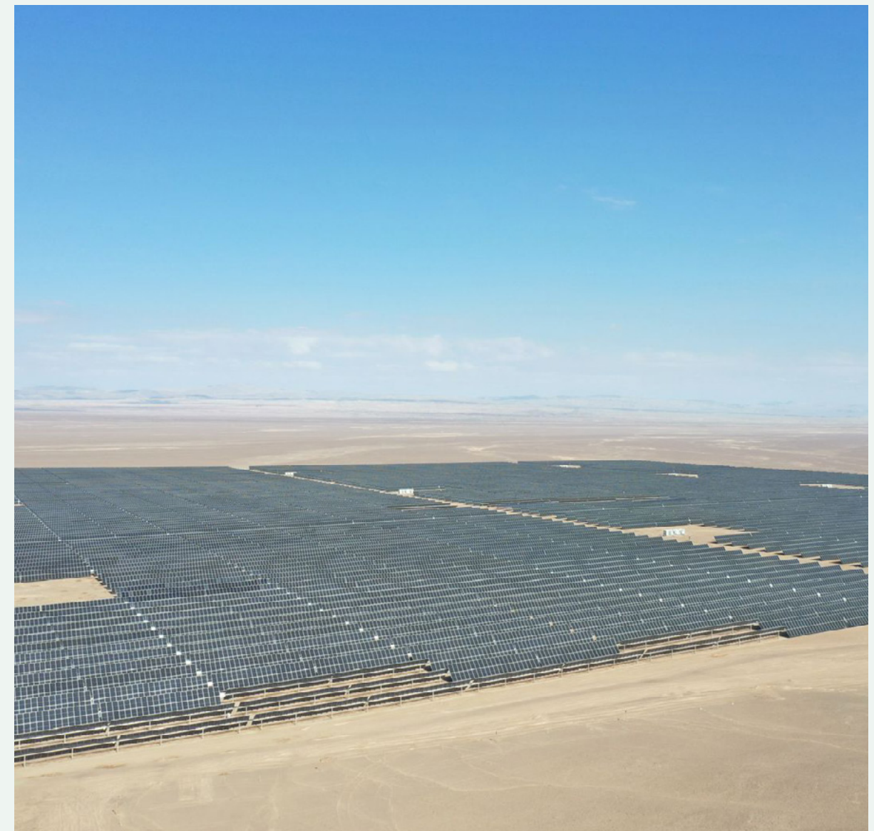
Planta fotovoltaica Coya, de 200 MW. Chile.
