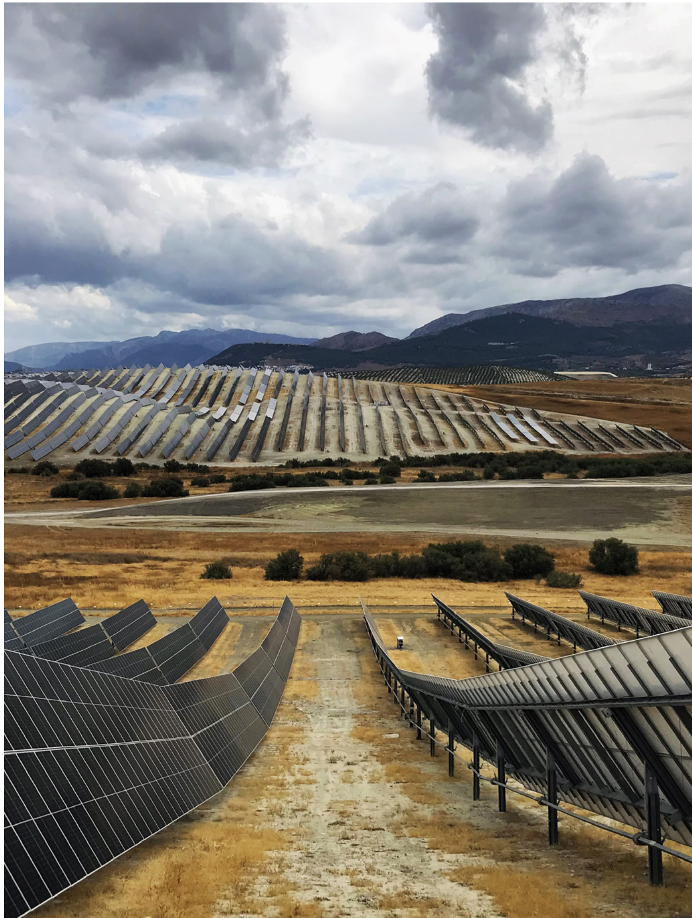
Los Olivares Solar Park. Spain.
